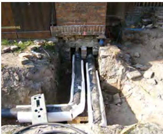
Anschlussstelle der Dorfheizung
