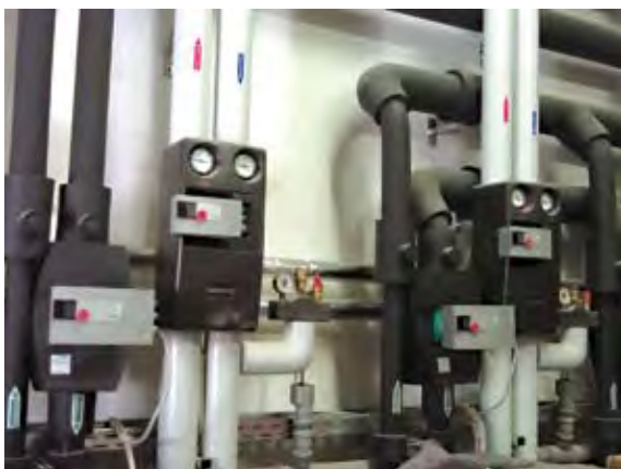
Wärmepumpe im Gymnasium
