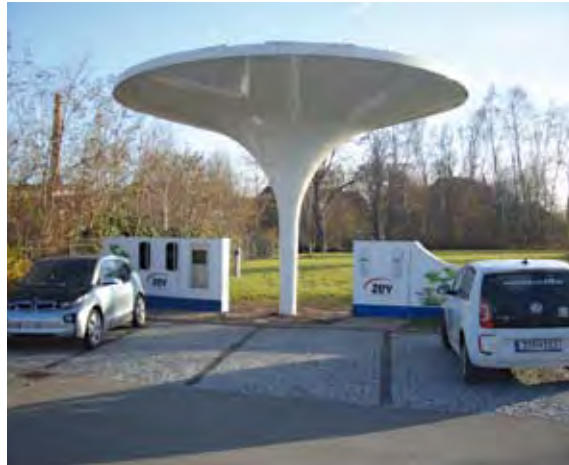
Mehrere Fahrzeuge können gleichzeitig Strom tanken
