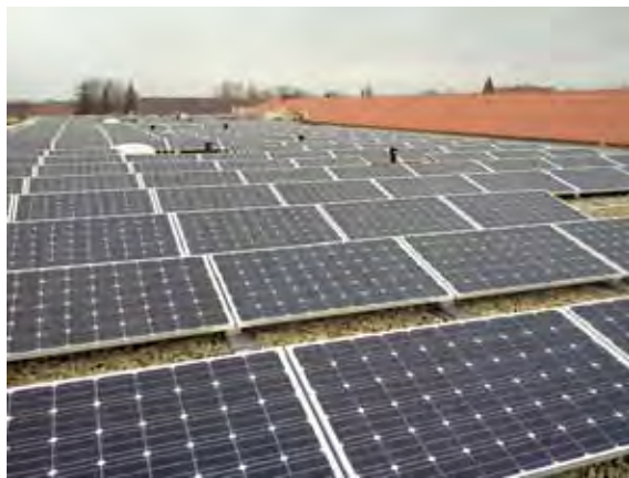
Photovoltaik-Anlage auf dem Dach der Schule
