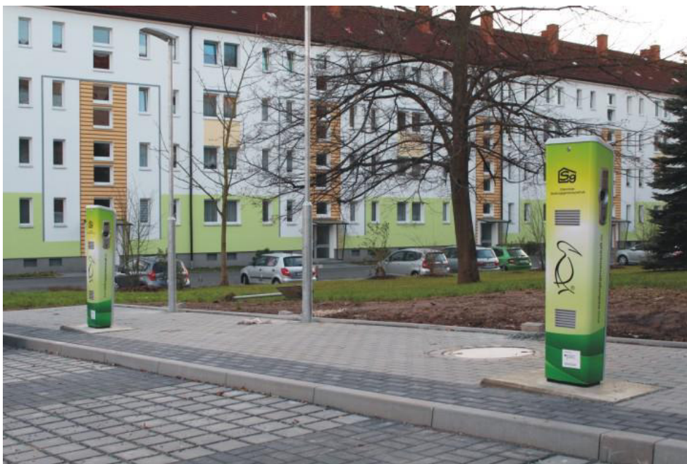
Foto: Ladesäulen aus dem Winner Projekt in der Alfons-Pech-Straße, Chemnitz 27
